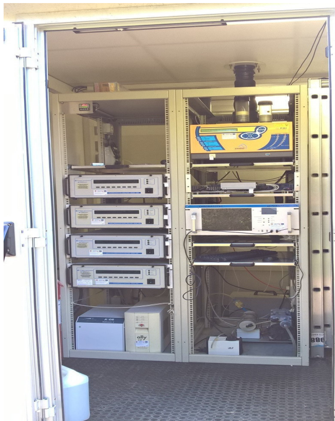
Panoramica interno cabina
