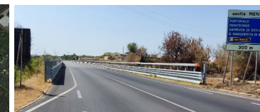
Figura 3-5- Barriere di sicurezza
